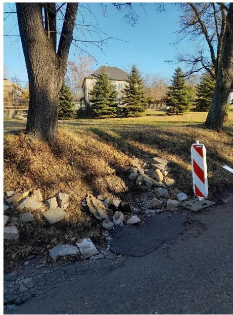
č.6 Odlehčení dešťové kanalizace, ul. U Radnice
